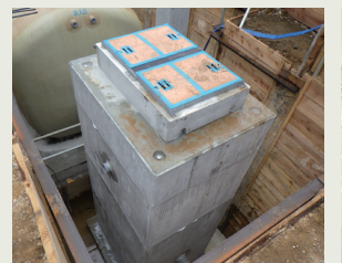
原水ポンプ槽設置例
